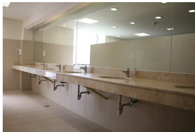
Baños con sifones ahorradores de agua
